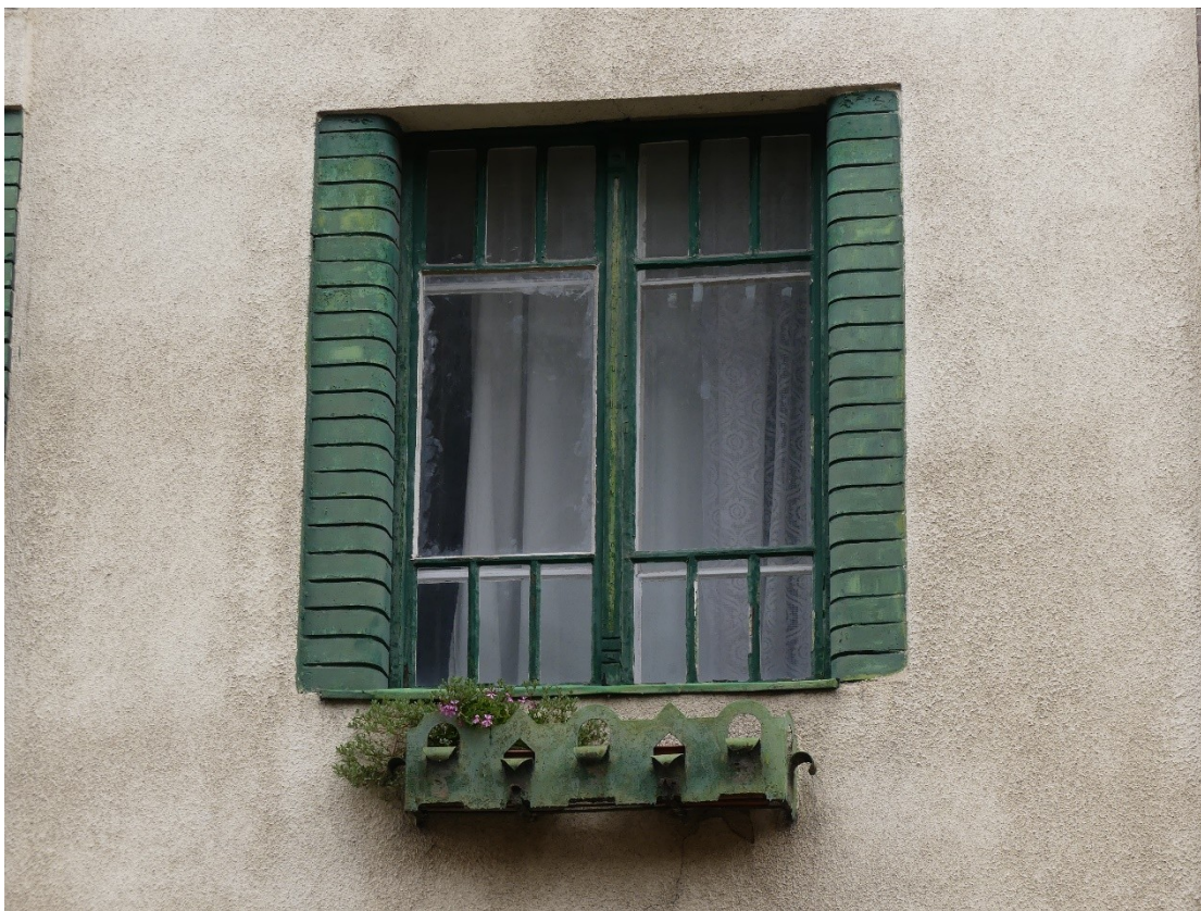
12. kép Budapest VIII. Alföldi utca 18. kislakásos bérház, ablak a főhomlokzaton
