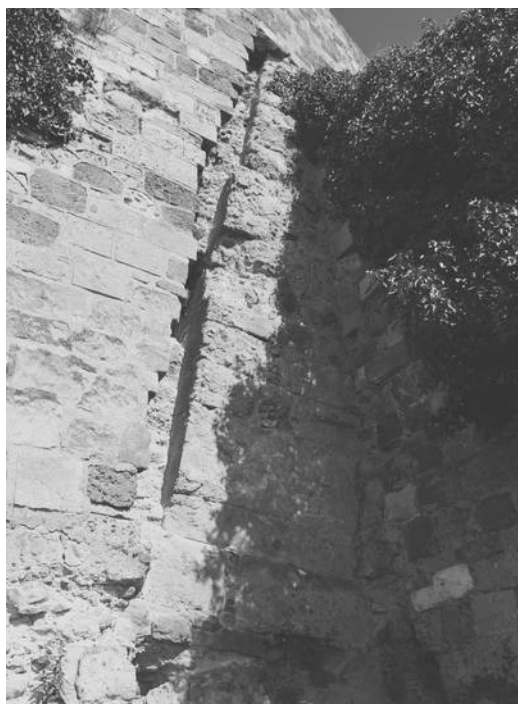
Az 1960-as években falkutatással feltárt támpillér (M4p) a nyugati várfalban (a szerző felvétele), amely a modenai felmérésen is beazonosítható. Lásd: 3. ábra.
